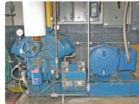
(3) Vilter Ammonia Compressors
